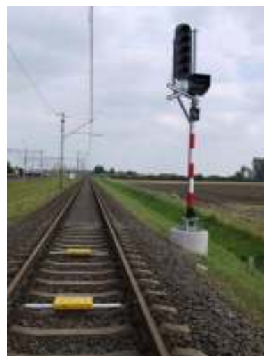
Semafor „stacyjny”, balisy przelączalna i nieprzelączalna
